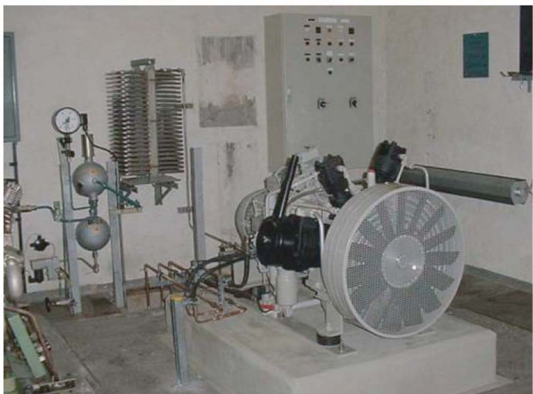
4-ступенчатый компрессор WP 4341 (60 м 3 /ч; 16 МПа). Управление электрическими переключателями подстанции TEAG AG UW (Gera-Langenberg, Германия)
